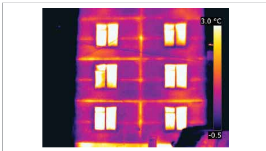
Рис. 5.2 Пятиэтажный дом серии ГИ постройки 1960-х годов «светится» от теплопотерь меж- панельных стыков. Решением (если речь не идет о сносе или капитальном ремонте) может быть только качественный ремонт фасада с примене- нием современных материалов
